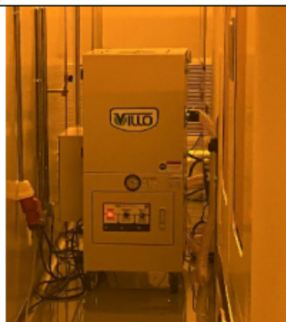
激光钻孔设备自带布袋除尘器
