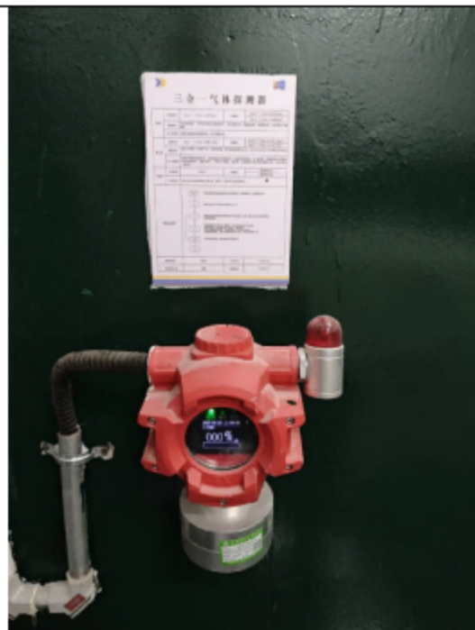
化学品库房气体泄漏报警装置
