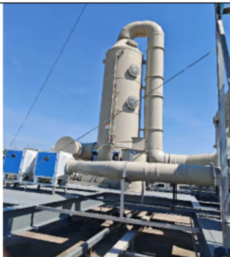
二级碱液喷淋塔（立式双层塔）
