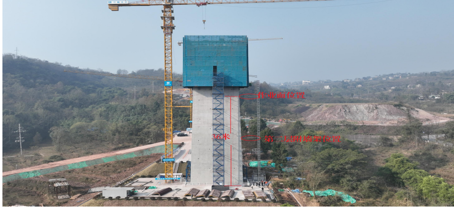
图3 事故现场三斗丘双线特大桥项目13号桥墩
