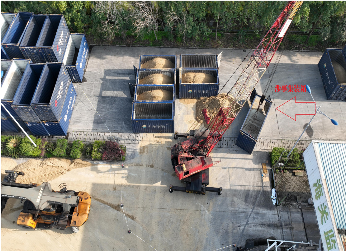
图 1 事故现场俯视图
