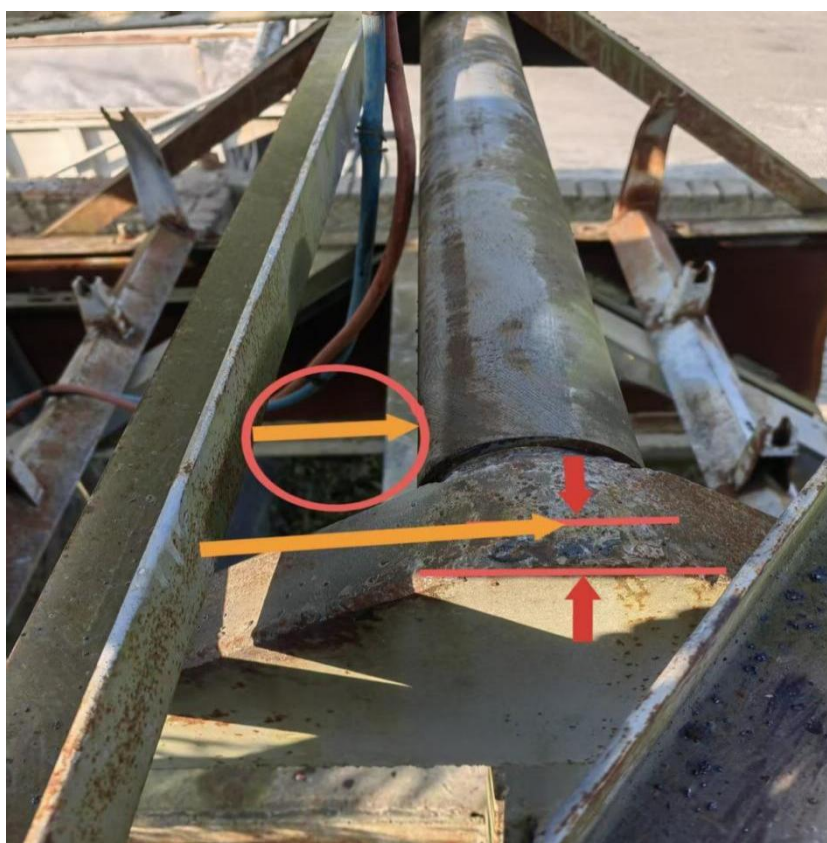
图 4 上下两部钢构机架（上架因切割支架掉落产生振动引发位移，下落压住朱**头部）
