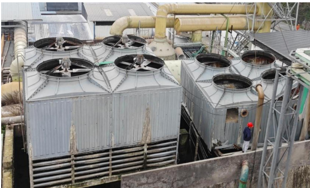
图5 涉事冷却塔坍塌俯视图
