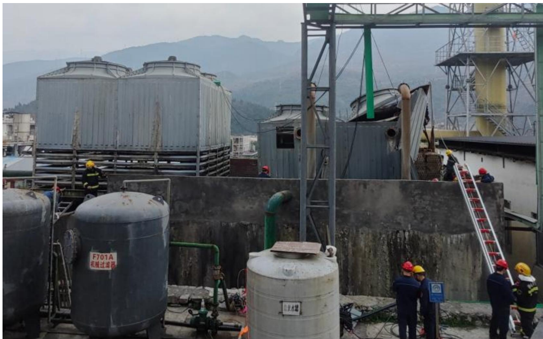
图4 涉事冷却塔坍塌正面图
