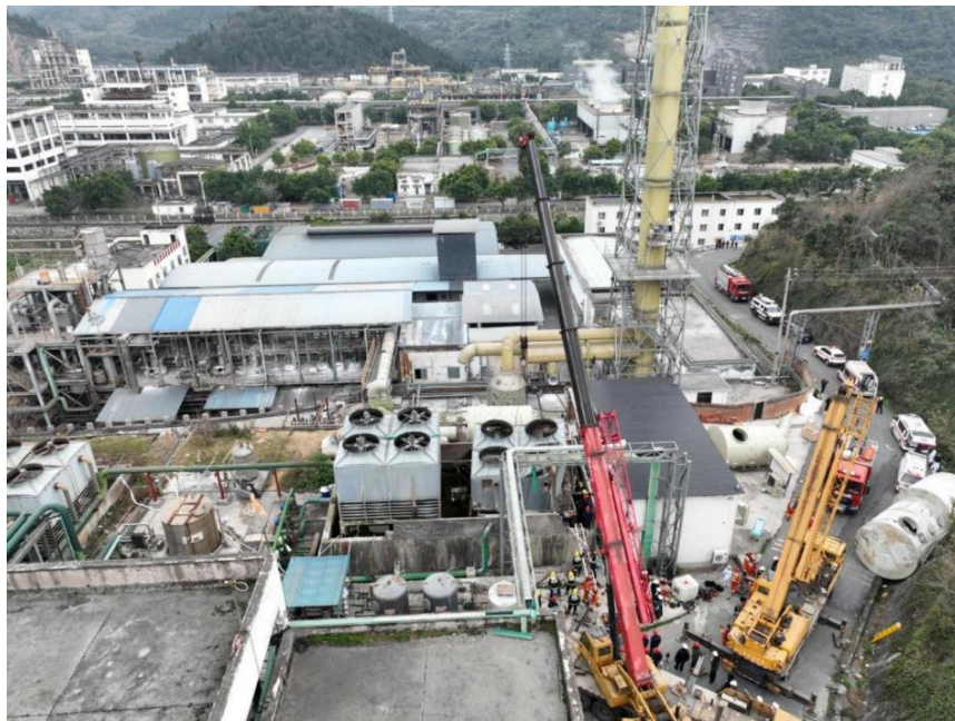
图7 事故救援现场全貌图
